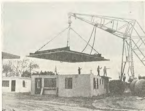
Fig. 2.9. Anvendelse af vacuum-måtter til løftning af en betonplade på 13 tons. Pladen kan løftes dagen efter støbningen, fordi måtten løfter over hele pladens areal. — Vacuum Concrete S.A.
