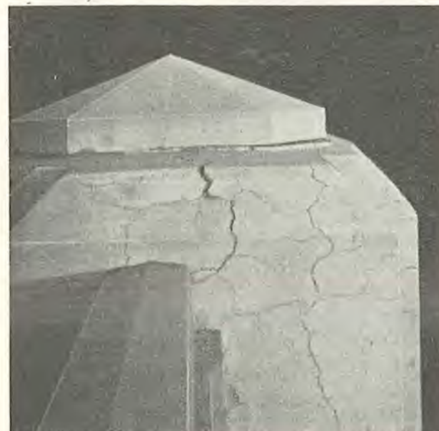
Fig. 2.17. Revnedannelse i broværk på Sixth Street Bridge, Los Angeles, som følge af reaktioner mellem cementens alkalier og gruset.
