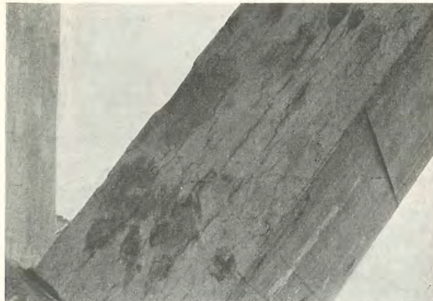
Fig. 3.9. Revnedannelse i bro på Sjælland. Skader fra »springere« er udbedret med mørtel.
