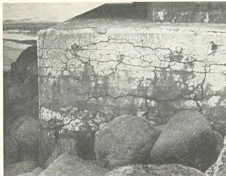
Fig. 3.13. Revnedannelse i betonpille i Nordjylland. Bygværket er ca. 15 år gammelt.
