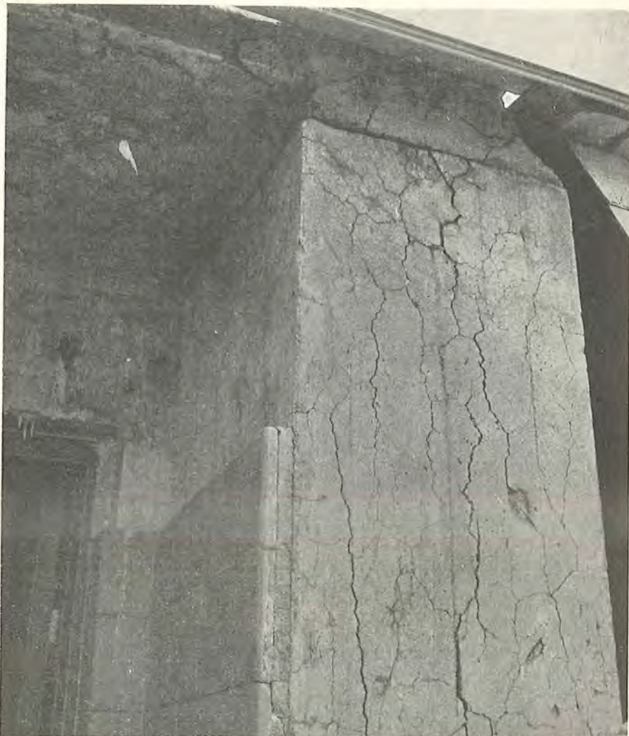
Fig. 3. 14. Revnedannelse i betonbygværk i Nordjylland.
