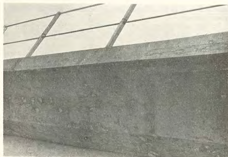
Fig. 3.10. Revnedannelse i bro på Sjælland. Langsgående revner i kantbjælke. Udblomstringer omkring udbedrede huller efter »springere«.
